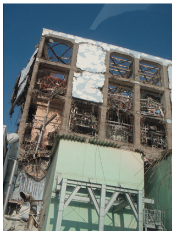
事故で破壊された福島第一原発 4 号機 2011 年 7 月 撮影：JANIC
