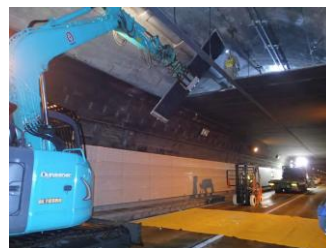
← 天井板を撤去する工事の様子 (酒田河川国道事務所 HP より)
